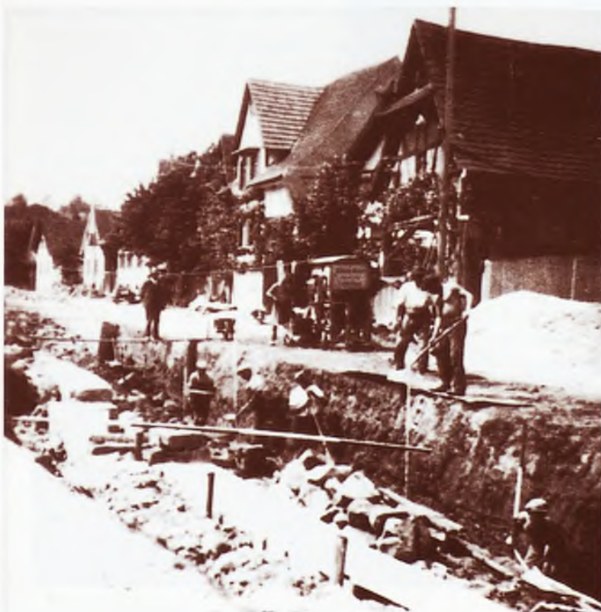
Hochwasser in der Bachstraße Nachdem der Sulzbach mehrmals die Bachstraße überflutet hatte und große Schäden verursachte, entschloß sich die Gemeinde das Bachbett zu erneuern.
